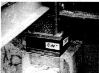
Bild 8. Elastomerlager am Übergang zum Stahlskelett
