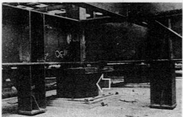
Bild 1. Elastomerlager an den Stützenfüßen im Gerichtsgebäude von San Bernardino County
